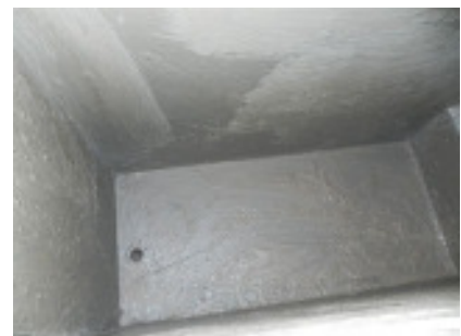
So sieht der Tank aus, nachdem er neu ausgestrichen ist. Gute Arbeit, Roy!
