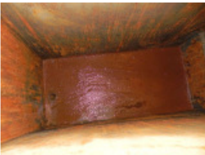
So sieht der Wassertank (nach 5 Jahren) von innen aus.
